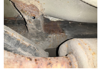
Kaporta, Sağ Arka Şase > Hasarlı
