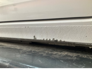
Marşbiyel, sol, Marşbiyel, sol > Hasarlı
